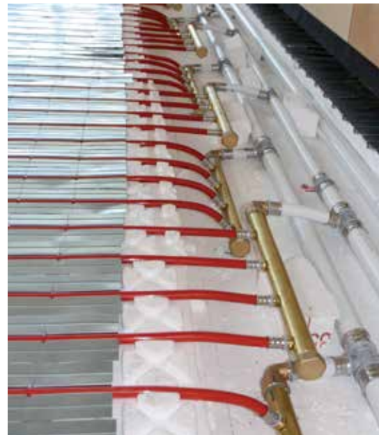
Die Anbindung der Heizkreise der Roth ClimaComfort® TBS Flächenheizung in der Hinterlandhalle Dautphetal erfolgt über ein Tichelmann-Verteilungsnetz
